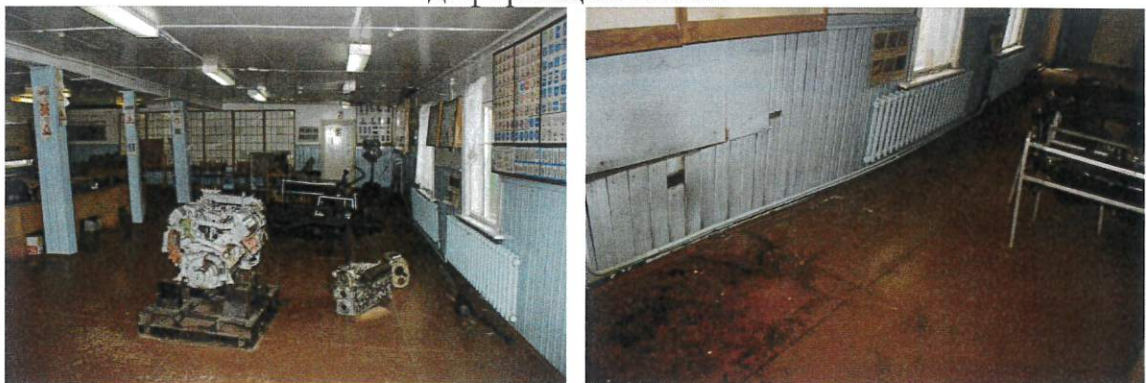
общие деформации пола, вызванные гнилостным повреждением
