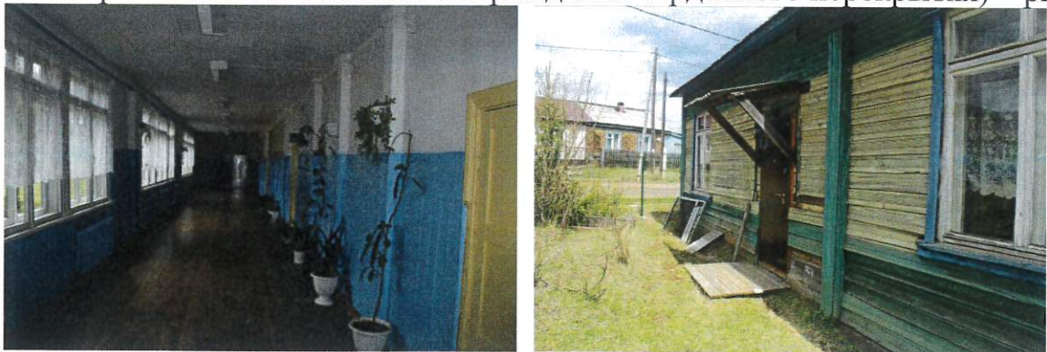
общие деформации стен
