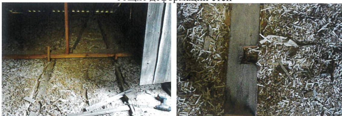
участок чердачного перекрытия с прогибами по балкам и расстройством узлов опирания
