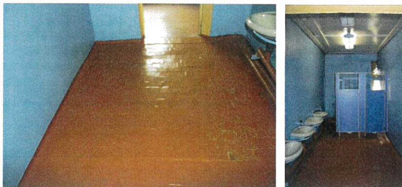
деформаций бетонного пола
