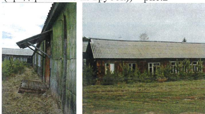
общие деформации стен
